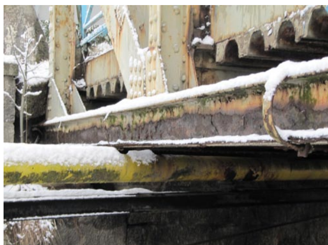
Rys. 4. Widok stanu technicznego pasa dolnego kratownicy od strony wody górnej (zdjęcie własne autora)
