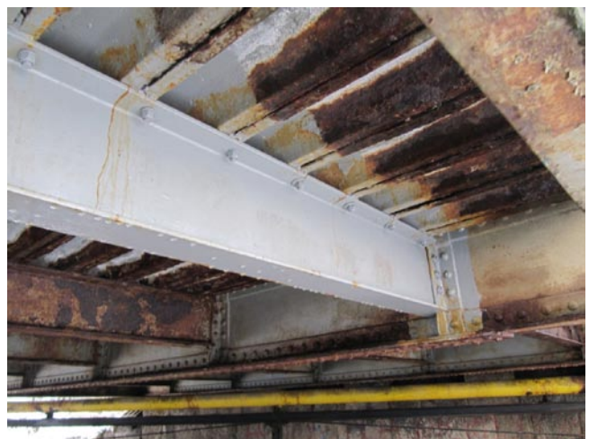
Rys. 3. Zaawansowana korozja wżerowa z rozwarstwieniem elementów stalowych: podłużnic, poprzecznic oraz zoresówek – widoczna również doraźnie wymieniona podłużnica (zdjęcie własne autora)
